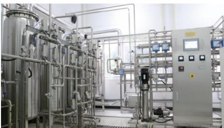
大型中央水处理系统
